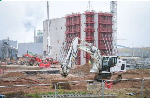
Structure de la nouvelle centrale de cogénération biomasse à Golbey. Décembre 2022. Crédits Vosges Matin, Jérôme Humbrecht
